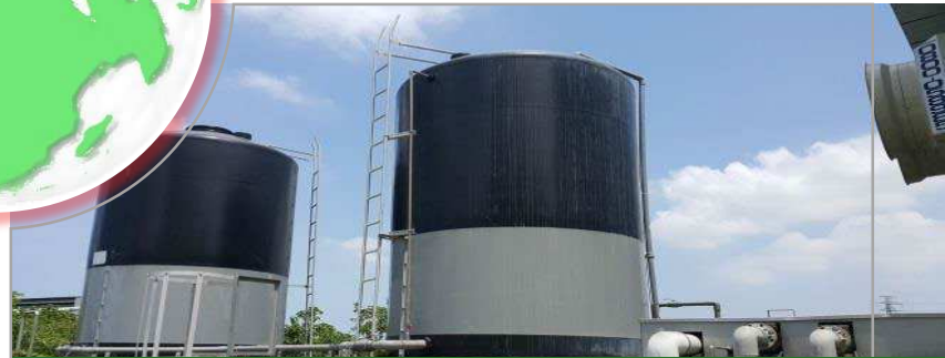
RO water reuse
